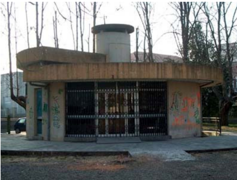
La struttura degradata (marzo 2003)
