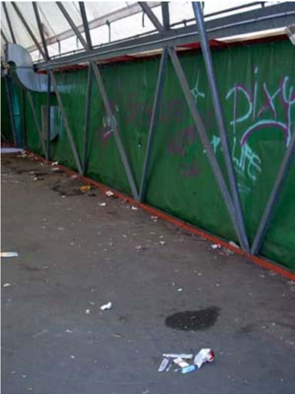
Lo stato di abbandono dell'ex campo coperto (settembre 2004)
